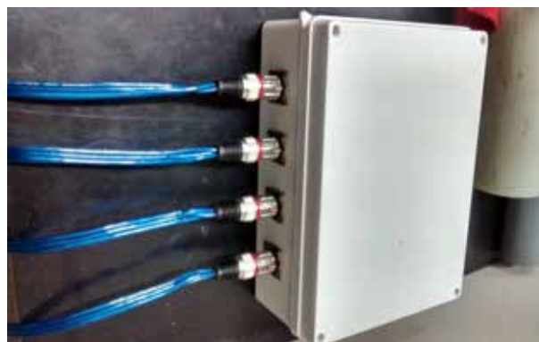
Figura 2. Caja de resguardo, protección y seguridad a la intemperie para el equipo de medición.
